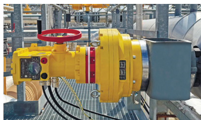
Электропривод РэмТЭК.П.10000.16 (крутящий момент 10 000 Н·м, время перекрытия 16 с) на поворотном затворе линии регенерации компрессорной станции «Казачья» ООО «Газпром трансгаз Краснодар»
